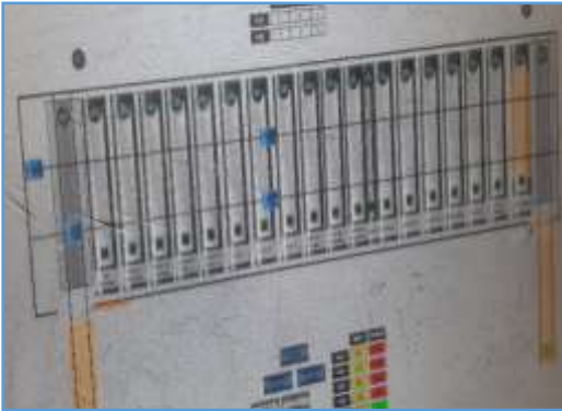
Asit Fosfat Hattı(Kontrol Panosu)-377
