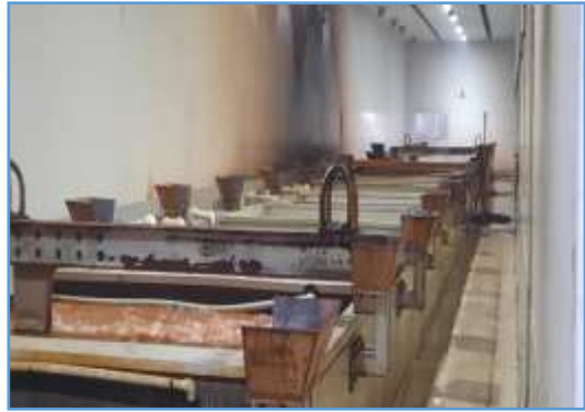
Asit Fosfat Hattı(Havuzlar)-377
