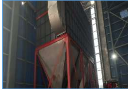
Galvaniz 2 Tesisi(Toz Toplama)-378
